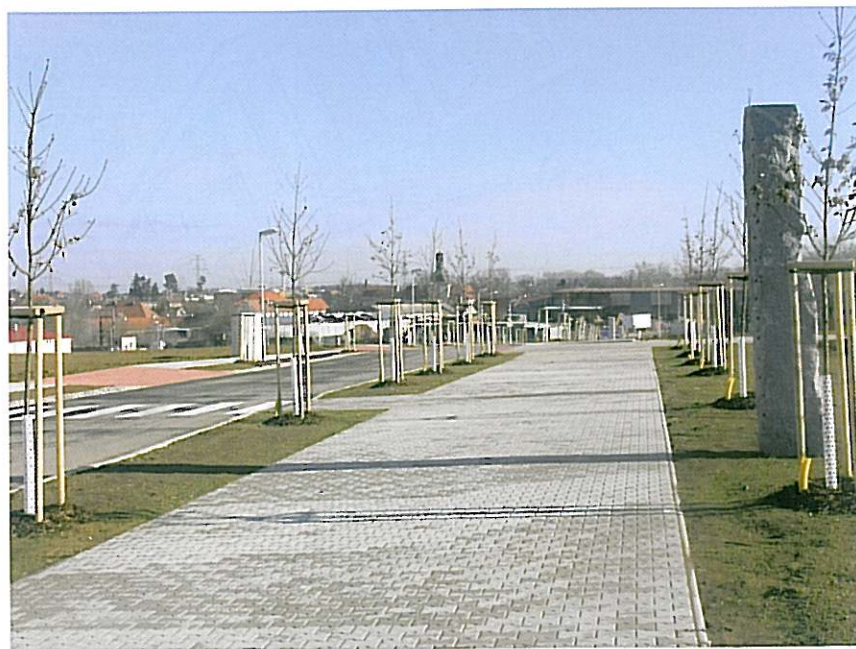
Další pohled do lokality Za Příkopem po ukončení výstavby infrastruktury a veřejné zeleně (oboustranné stromořadí v široké ulici) před zahájením individuální výstavby rodinných domů
